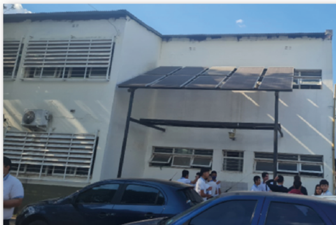
Imagen N° 2: Paneles solares instalados por estudiantes y profesores en la propia escuela.
